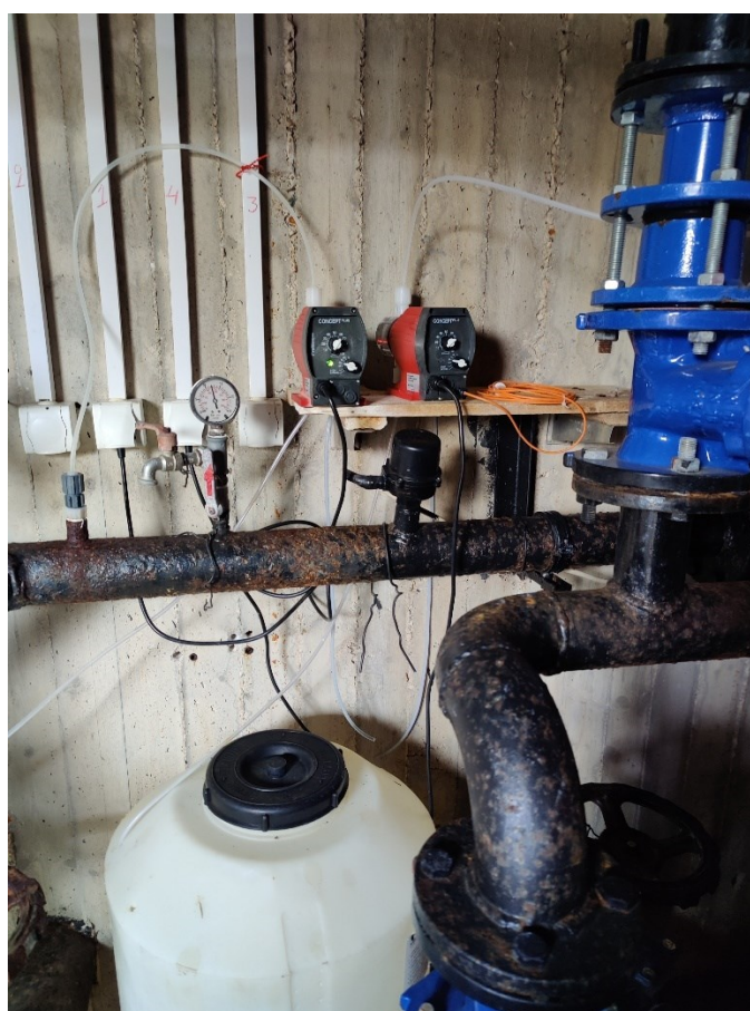
Εικόνα 9: Σύστημα χλωρίωσης στο εσωτερικό της πρώτης δεξαμενής στην κοινότητα Βώλακα.
