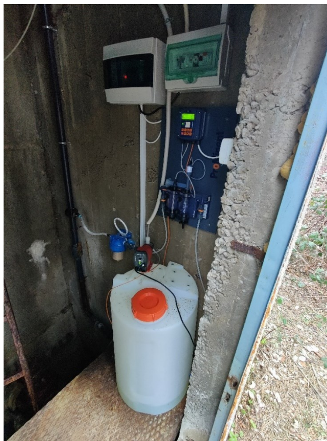
Εικόνα 15: Σύγχρονο σύστημα χλωρίωσης στη δεξαμενή της κοινότητας Λευκογείων.
