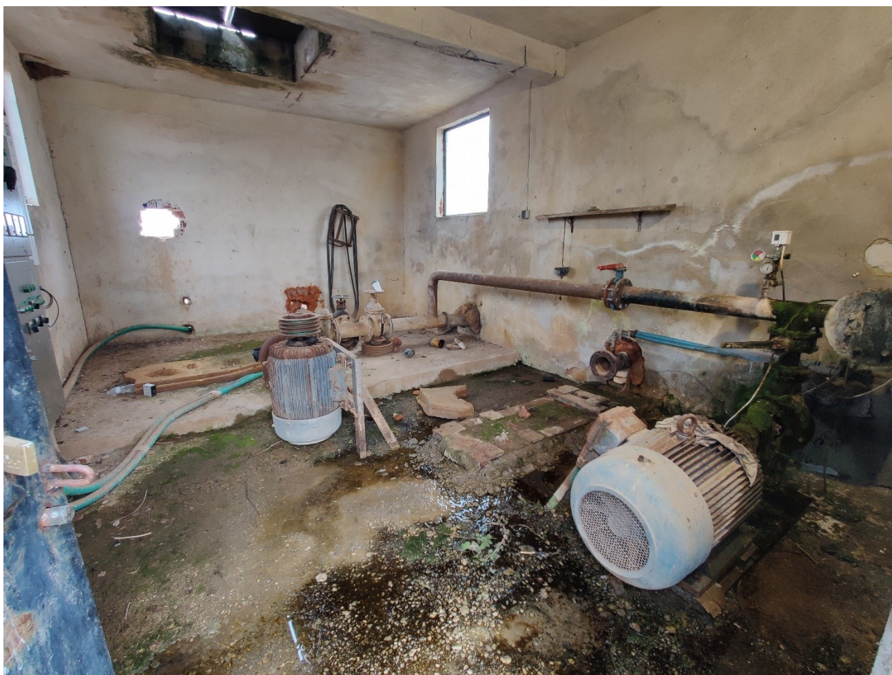
Εικόνα 16: Το εσωτερικό του αντλιοστασίου στην κοινότητα Οχρού.
